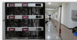
◀ 學生第一宿舍、綜合宿舍共裝設266間數位電錶
